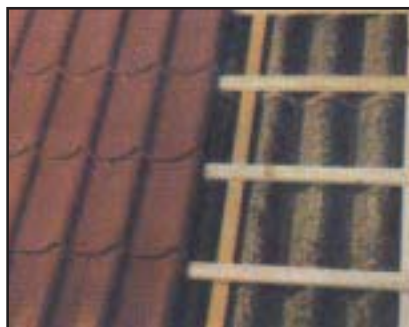
plaque ondulée à l'amiante
